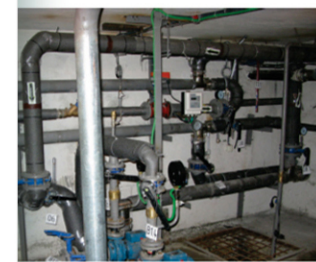
Рис. 7. Технический узел в подвале жилого здания
